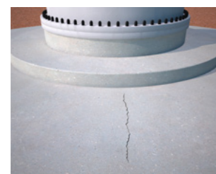
Évaluer et nettoyer la fissure.
