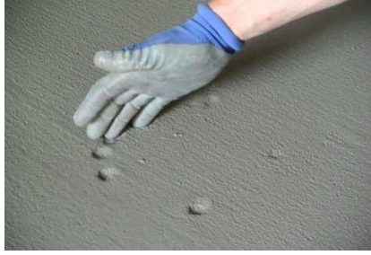
Figure 14 : chape manifestement trop peu durcie ; la profondeur maximale de l’empreinte du doigt ou de la chaussure doit être d’environ 1 mm.
