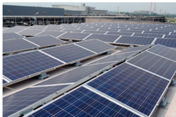
Centrale PV orientée est/ouest
