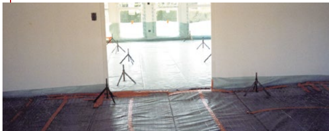
Joint au seuil de porte
