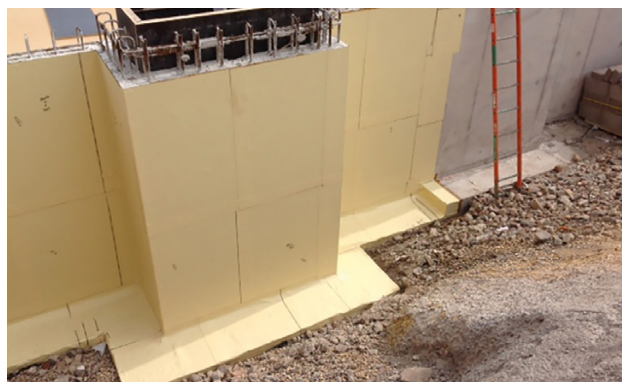
Fouille à ciel ouvert avec radier en débord des parois. L'ensemble de la structure est étanché avec SikaProof® P.
